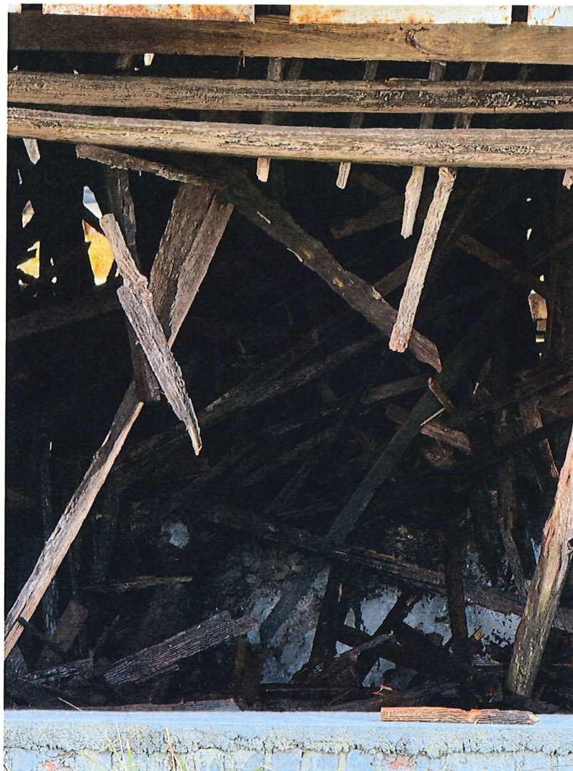
Zawalona konstrukcja wewnętrzna
