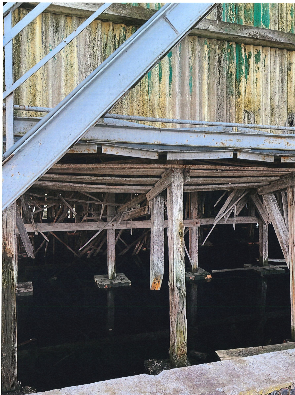
Zawalona konstrukcja wewnętrzna
