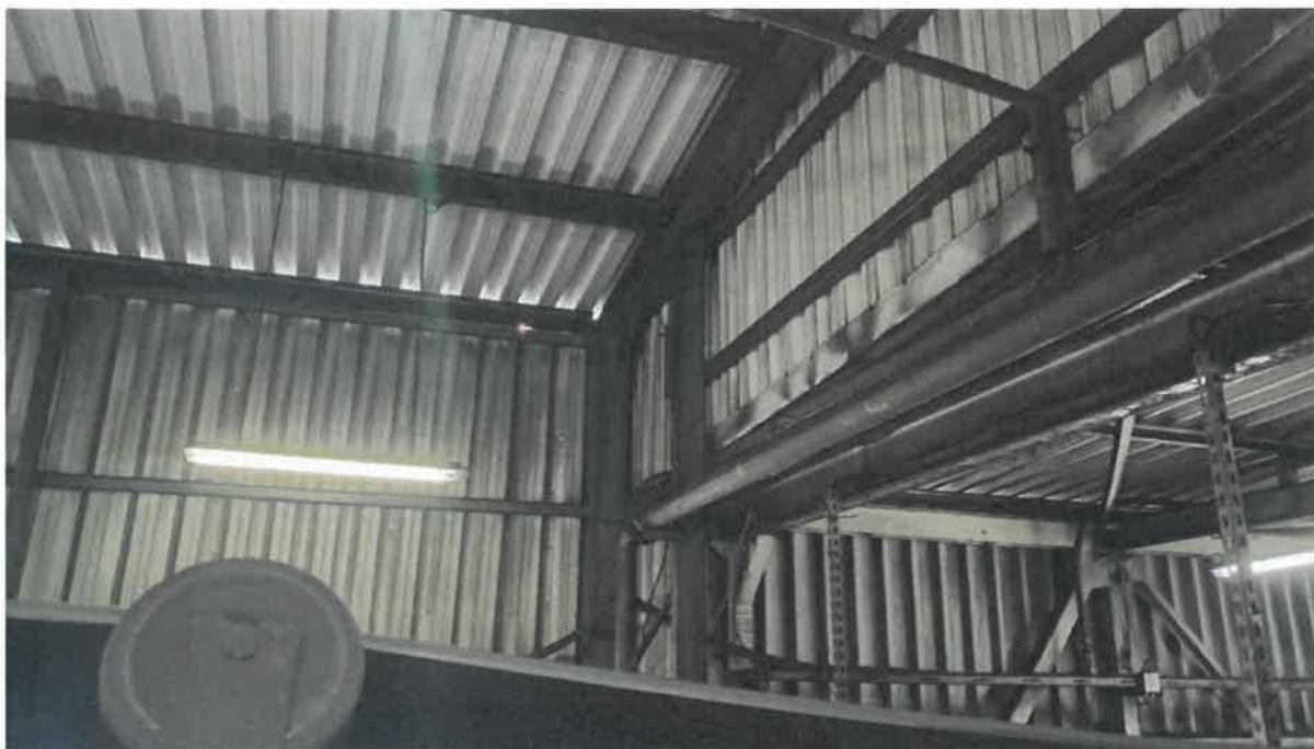
Fot nr 17. Węzeł 22+1/D; 22/D dla obu krat; 21+1/D górnego pasu kratownicy.
