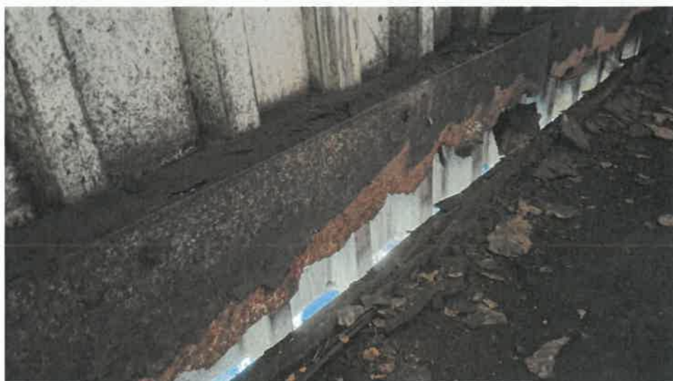
Fot nr 42. Widok skorodowanych obróbek w miejscu przęsła pomostu pomiędzy osiami 22 i 23.
