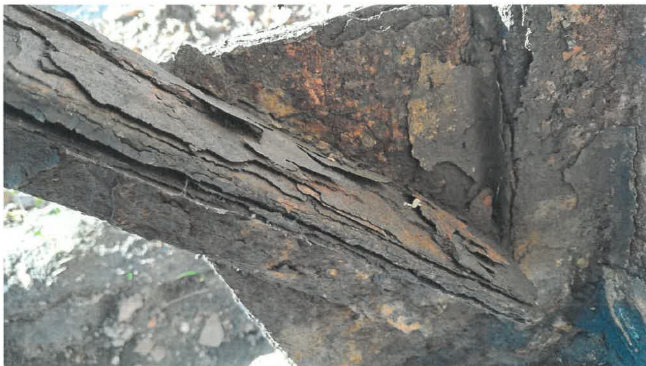
Fot nr 35. Widok podpory 21/D z silną korozją złuszczeniową elementów węzłowych.
