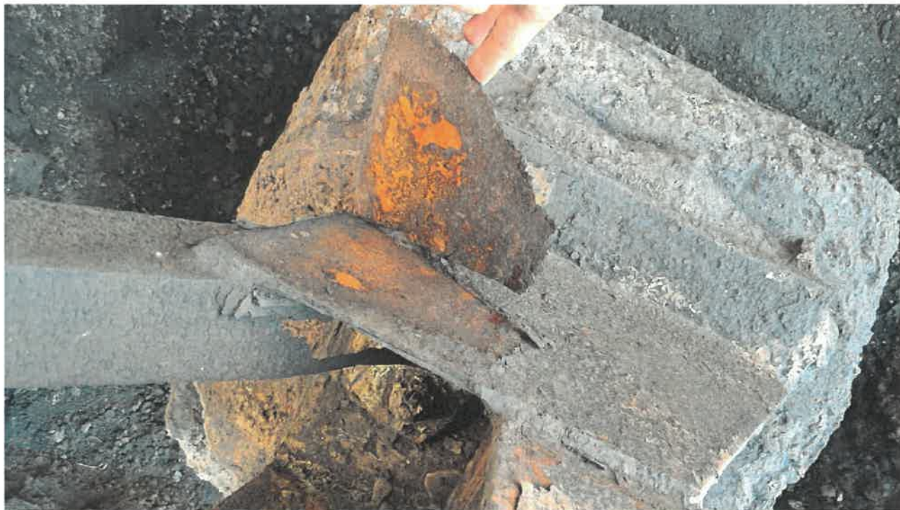
Fot nr 34. Widok podpory 22/C z perforacją profilu stężenia i łuszczeniem się blachy węzłowej.
