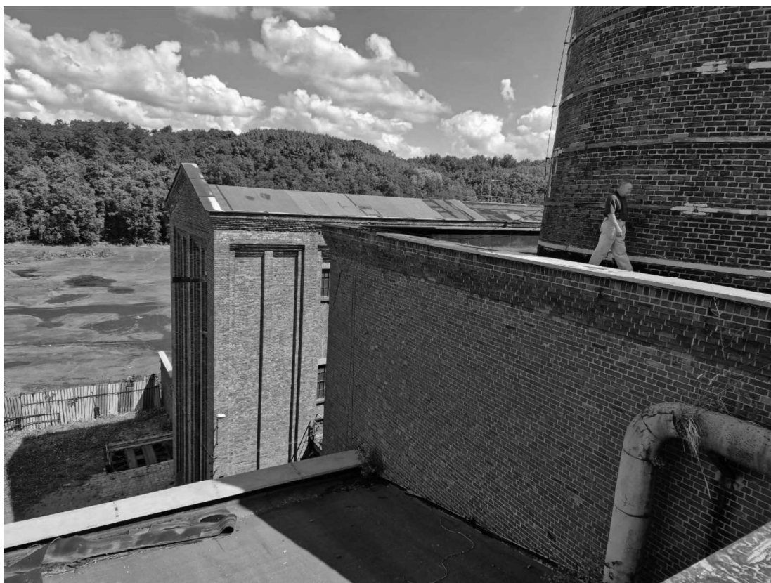
Zdjęcie nr 28. Zarysowanie ściany zachodniej w rejonie komina.
