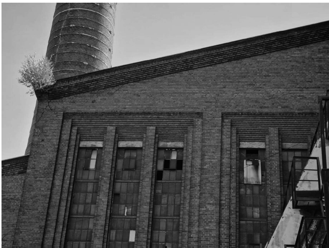
Zdjęcie nr 30. Zarysowanie naroża północno – zachodniego ściany budynku kotłowni oraz występowanie samosiejek roślin w ścianie od strony północnej.
