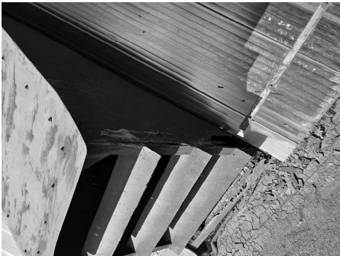
Zdjęcie nr 23. Korozja wywietrzników w poziomie światlików.
