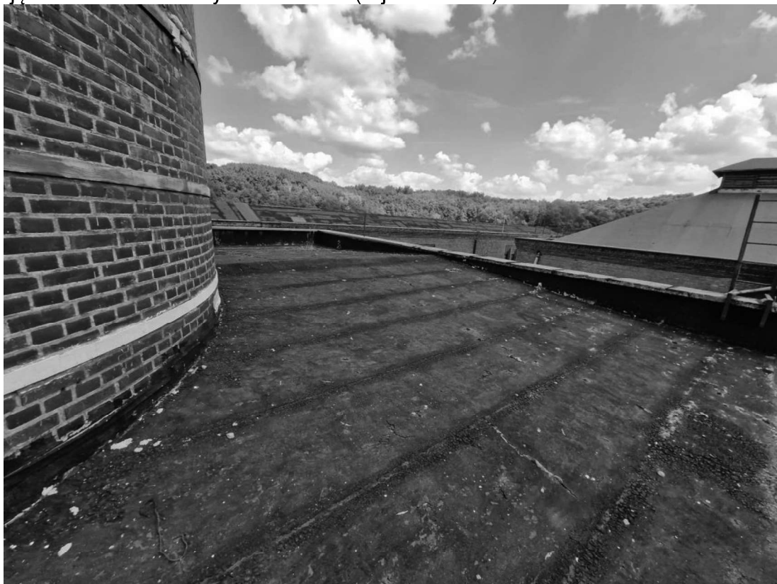
Zdjęcie nr 10. Dach budynku kotłowni (rejon komina) – widoczne spękania pokrycia z papy.
