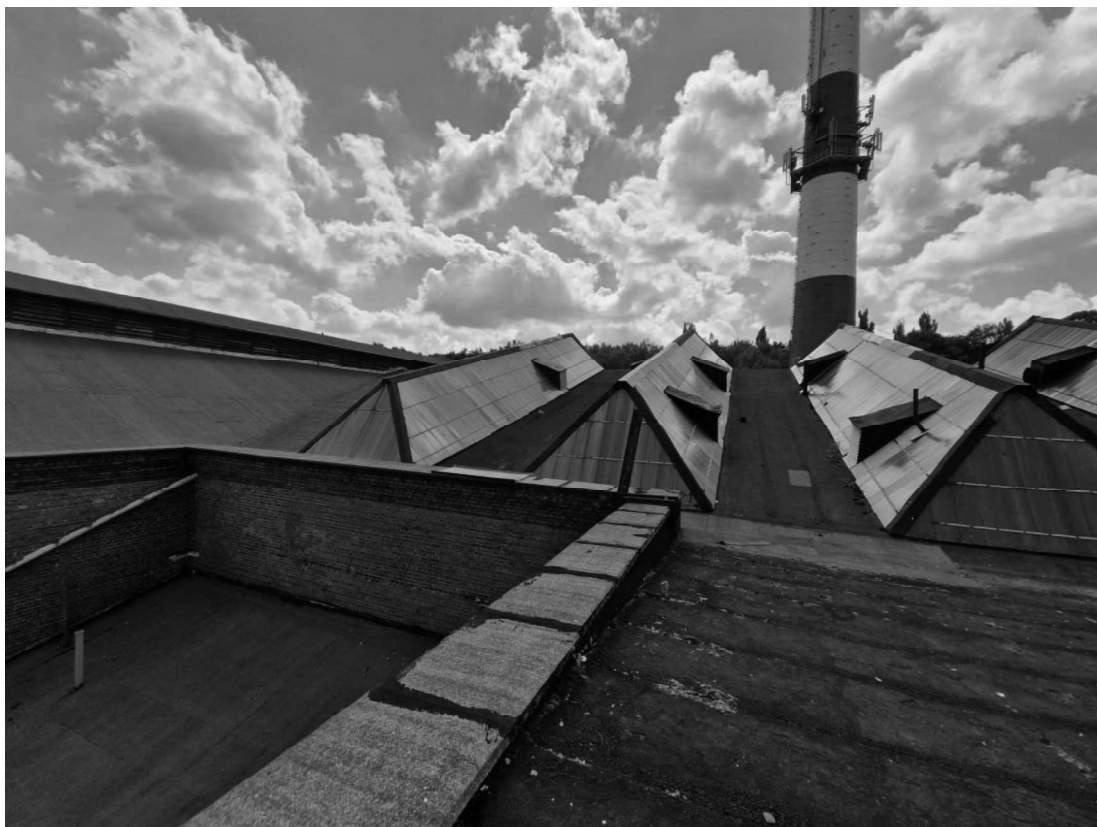
Zdjęcie nr 9. Dach budynku kotłowni (rejon komina) – braki obróbek blacharskich.
