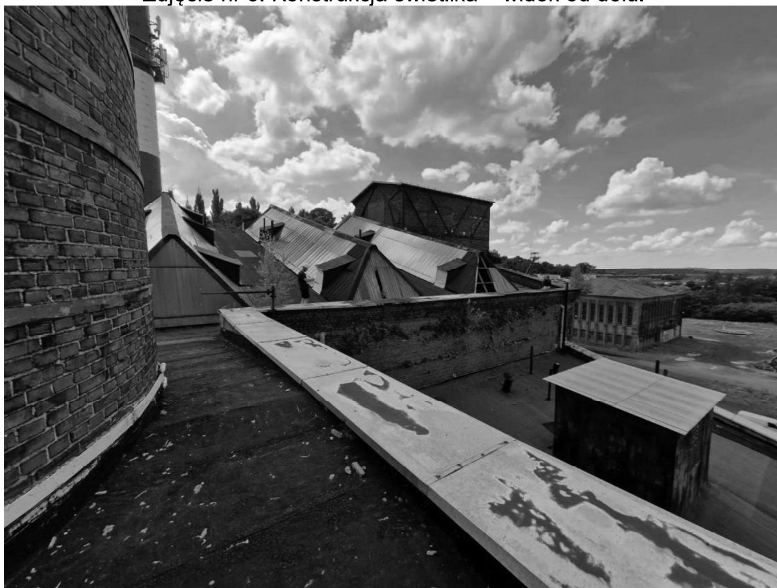
Zdjęcie nr 4. Dach budynku kotłowni (rejon komina) – widoczna korozja obróbek blacharskich attyki oraz występowanie samosiejek w ścianie północnej.
