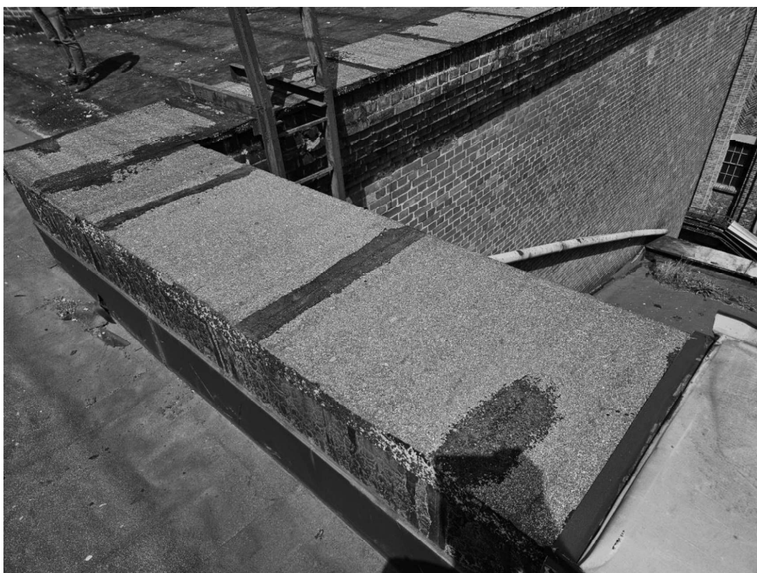
Zdjęcie nr 24. Braki w obróbce blacharskiej attyki.
