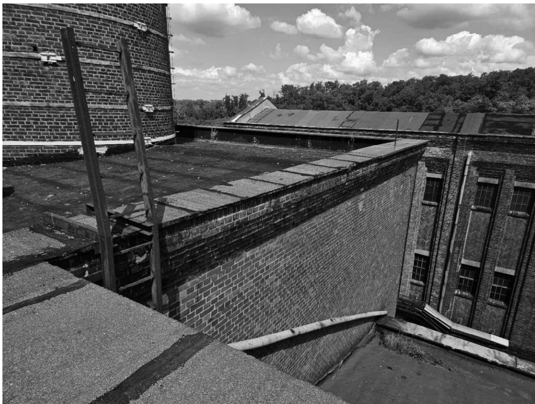
Zdjęcie nr 25. Zarysowanie ściany wschodniej w rejonie komina.
