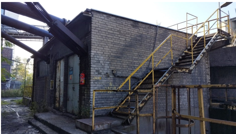
Fot. 5 Pompownia główna z rzapiami - widok od strony północnej.
