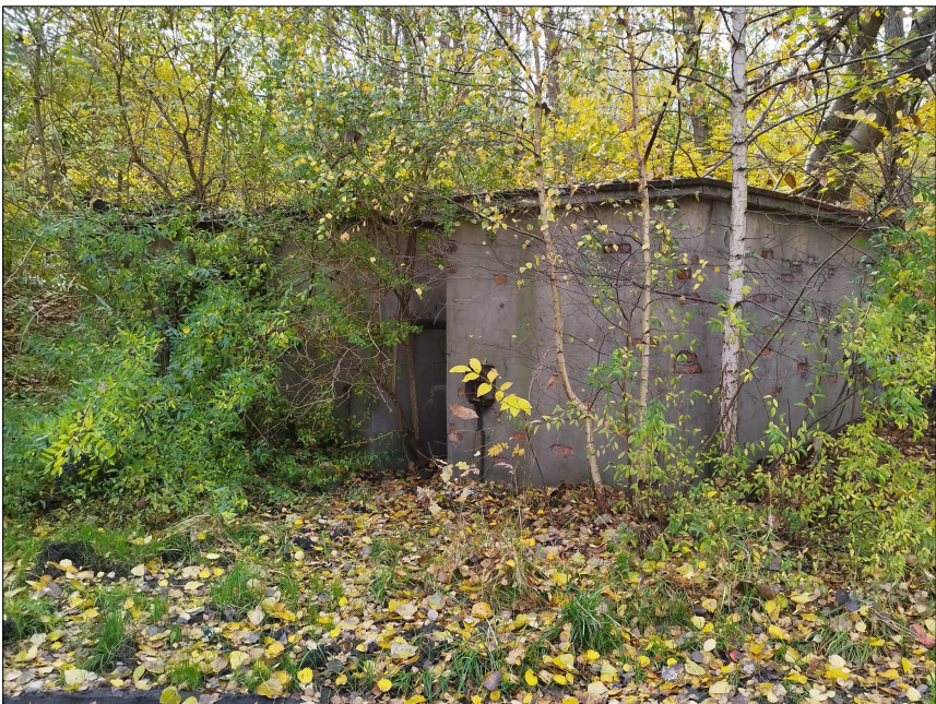
Pompownia wód popłuczkowych
