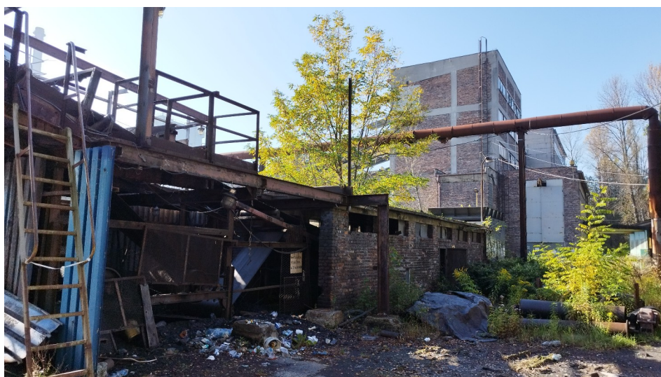
Fot. 12 Pomost przenośnika taśmowego 940A - widok od strony północnej.
