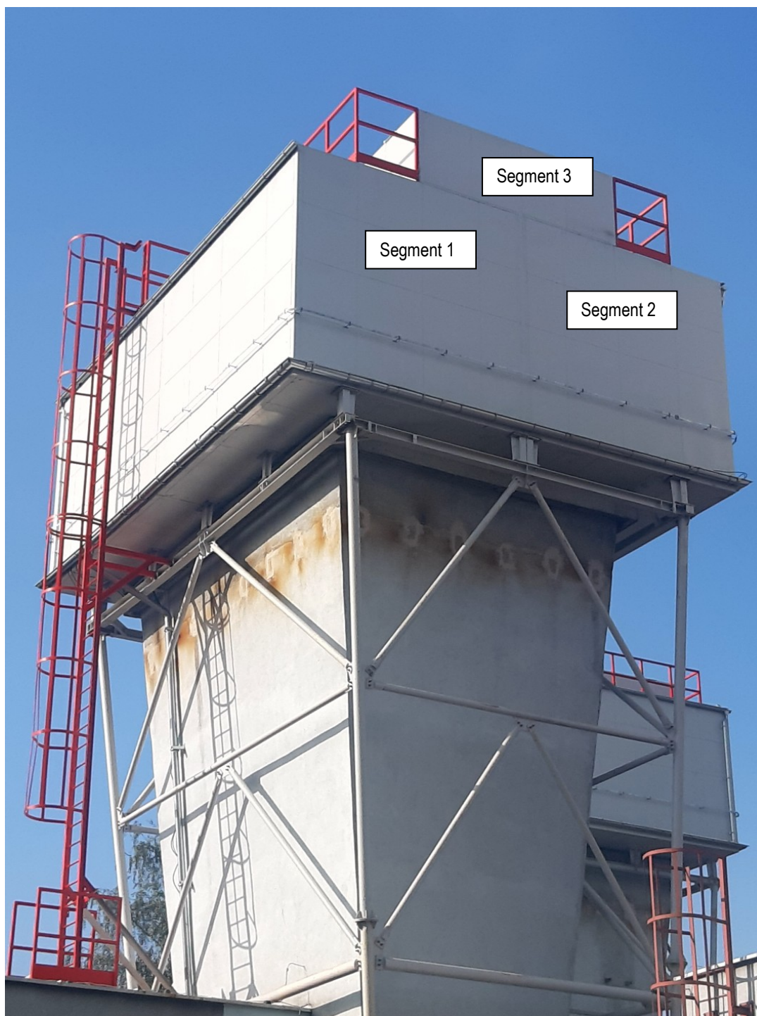
fot. 6.1 Tłumik wylotu z dyfuzora wentylatora WPK 3.3 na innej SWG
