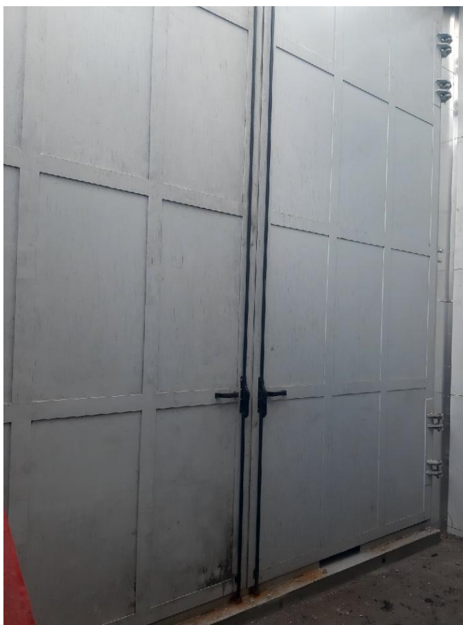
fot. 6.3 Ekran akustyczny w formie bramy na czerpni rewersyjnej wentylatora WPK 3.3 na innej SWG
