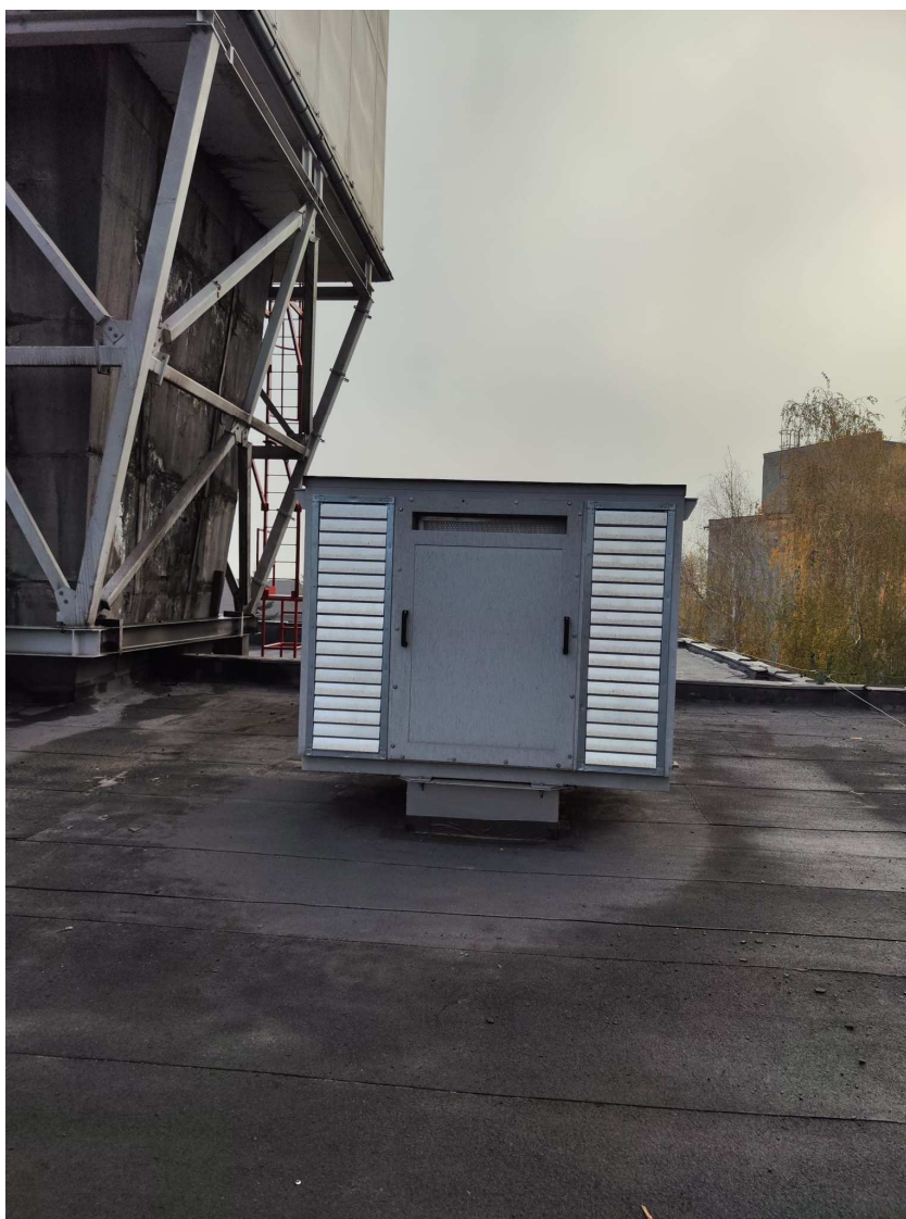
fol. 6.6 Zespół wentylacyjny wywiewny w budynku SWG na innym obiekcie
