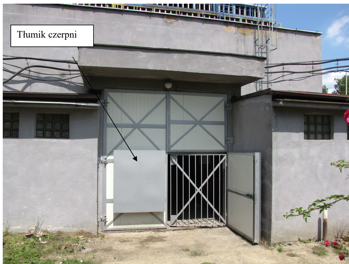
fol. 6.4 Brama do budynku SWG z wytłumioną czerpnią wentylacji - na innym obiekcie
