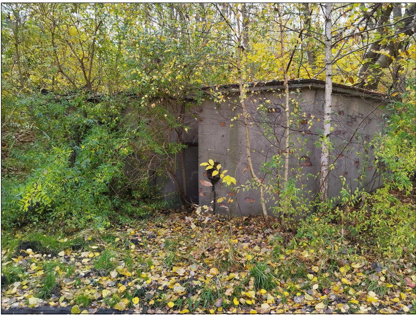
Pompownia wód popłuczkowych
