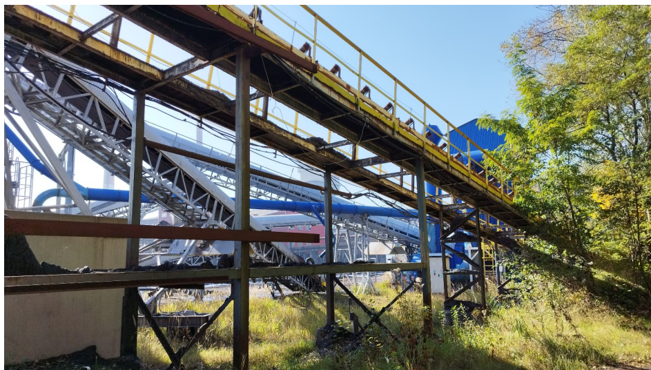
Fot. 15 Pomost przenośnika taśmowego 940G - widok od strony północno-wschodniej.
