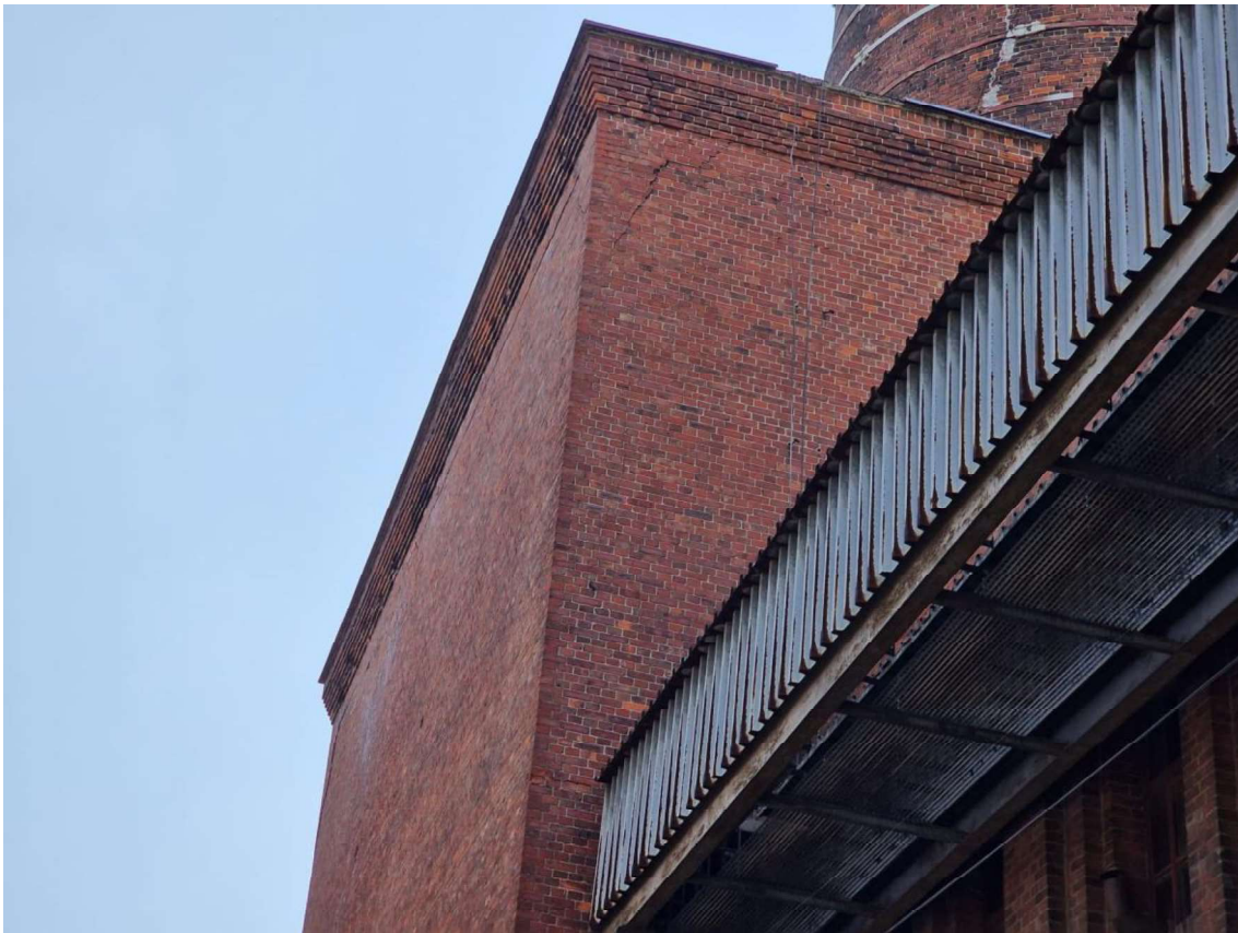
Zdjęcie nr 27. Zarysowanie narożnika ściany północnej i zachodniej w rejonie komina.
