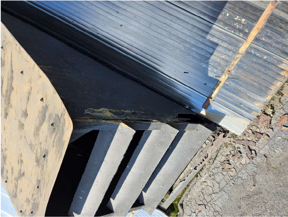
Zdjęcie nr 23. Korozja wywietrzników w poziomie świetlików.
