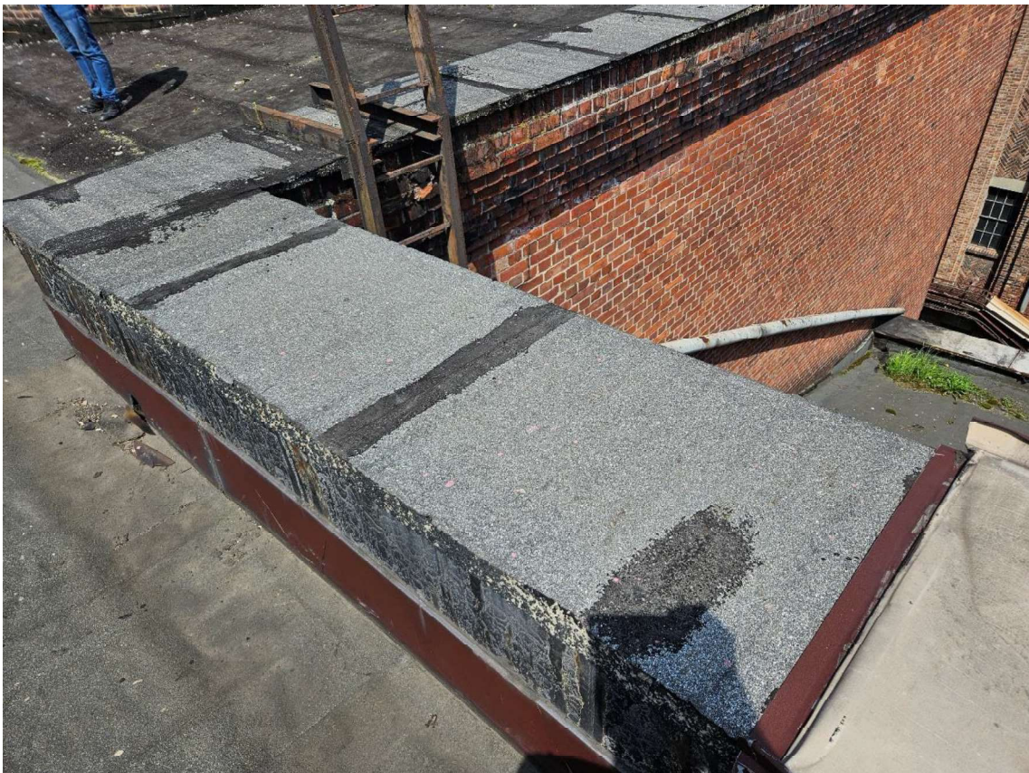
Zdjęcie nr 24. Braki w obróbce blacharskiej atyki.
