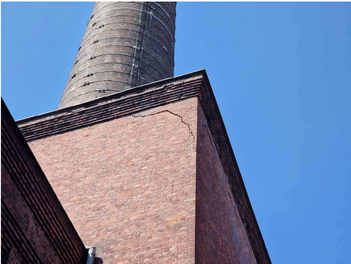
Zdjęcie nr 26. Zarysowanie narożnika ściany północnej i wschodniej w rejonie komina.
