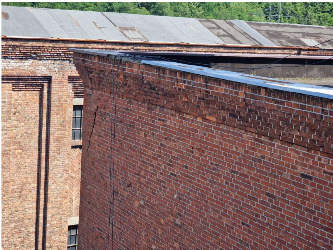
Zdjęcie nr 29. Zarysowanie ściany zachodniej w rejonie komina.
